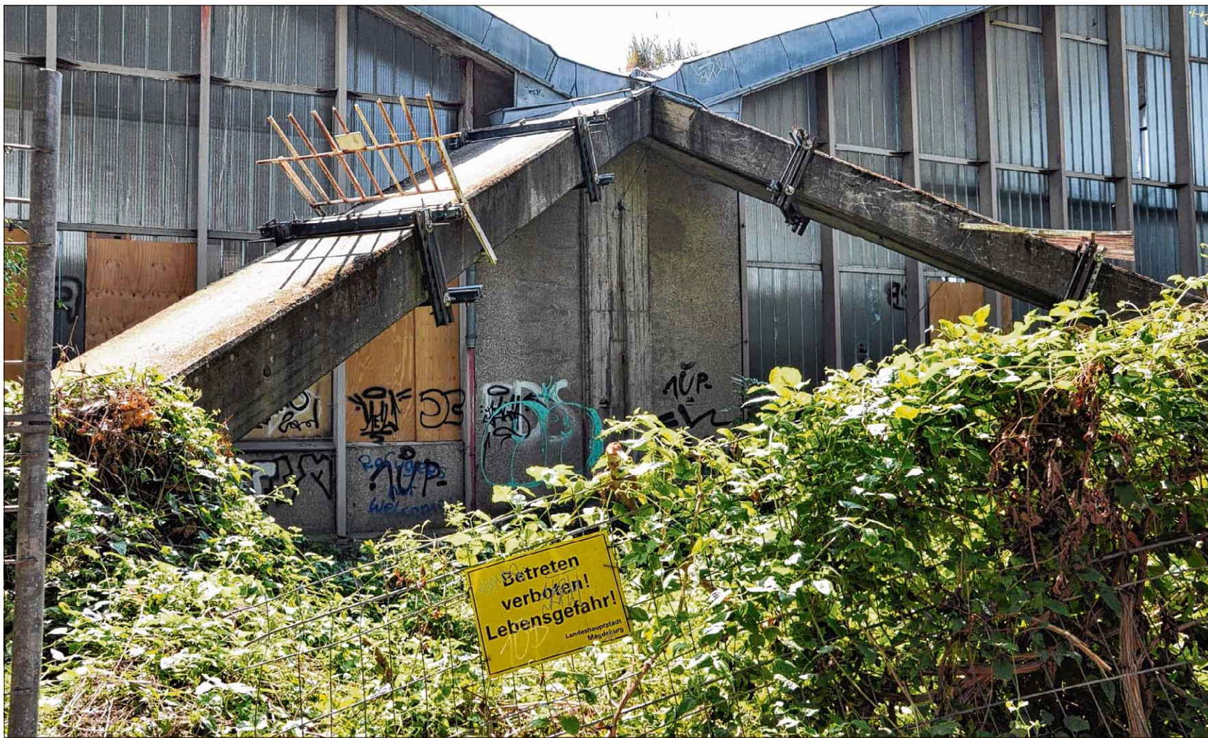
Baufällige Hyparschale: Der Zaun, an dem ein Schild Lebensgefahr verkündet, ist niedergedrückt. Verfall und Vandalismus nehmen ungebremst ihren Lauf. Foto: Peter Ließmann
